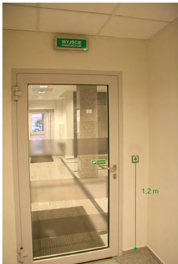
Rys. 3-1. Osprzęt elektryczny zamontowany na odpowiedniej wysokości
