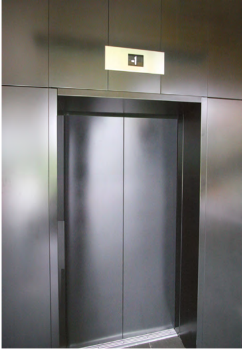
Rys. 8-1. Duży i kontrastowy wyświetlacz informacyjny, zamontowany nad drzwiami do kabiny dźwigu osobowego
