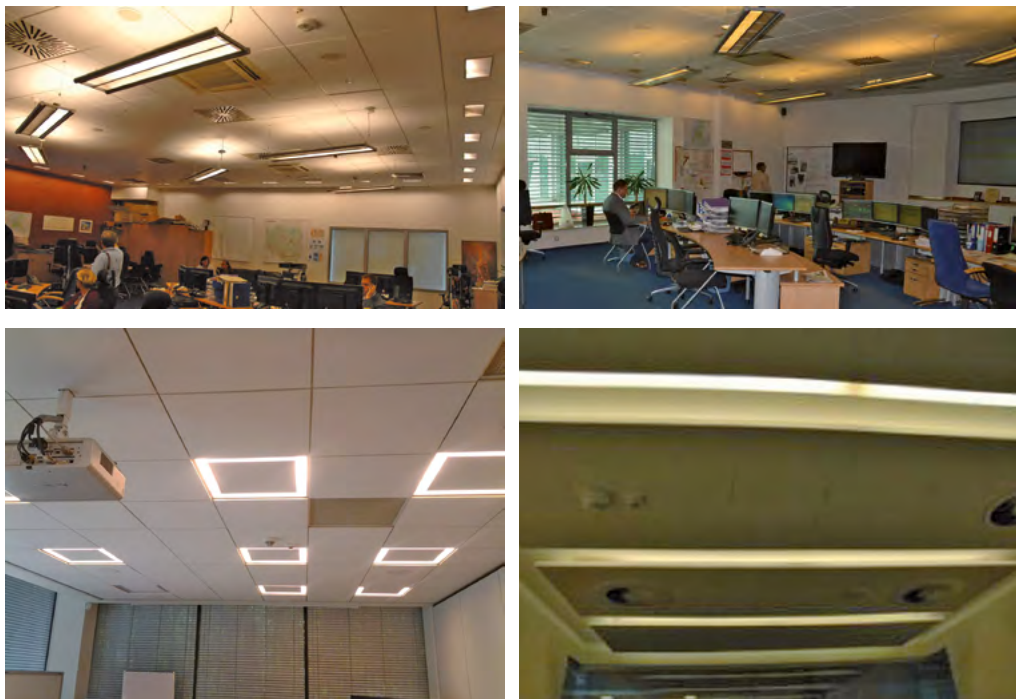
Rys. 28-1. Bezolśnieniowe oprawy oświetlenia ogólnego z możliwością płynnej regulacji strumienia świetlnego
