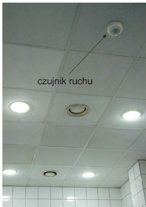
Rys. 31-1. Czujnik ruchu do załączania oświetlenia w pomieszczeniu higieniczno-sanitarnym
