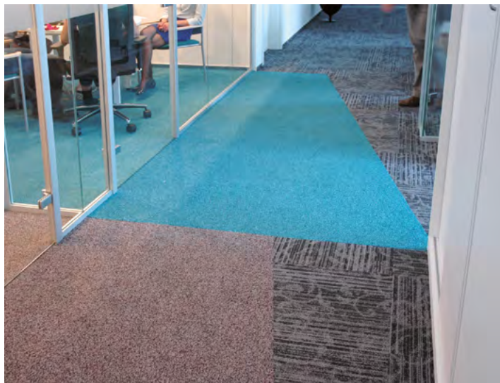
Rys. 22-1. Zróżnicowana barwa wykładziny podłogowej w sali konferencyjnej względem barwy wykładziny korytarza i innych pomieszczeń
