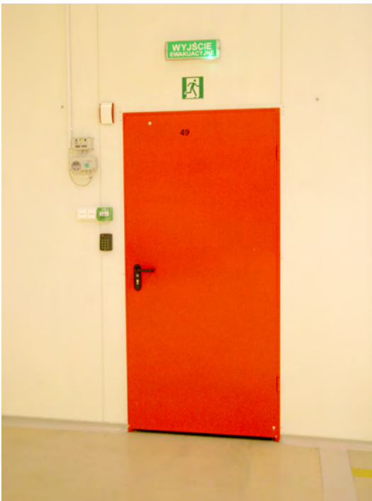
Rys. 25-1. Drzwi ewakuacyjne o kontrastowej barwie, innej niż pozostałe drzwi w budynku a) żółtej, b) czerwonej
