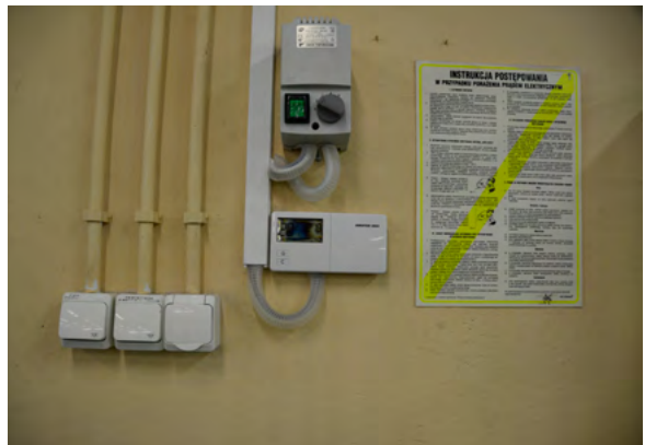
Rys. 79-2. Panel sterowania klimatyzatorem na wysokości włączników oświetlenia
