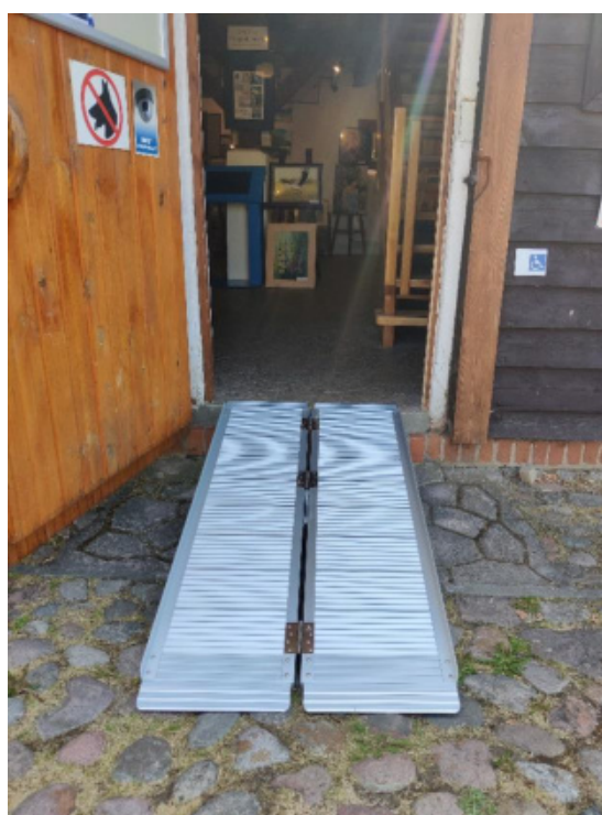
Aluminiowe szyny jednoelementowe przenośne w progu wejścia do budynku.
