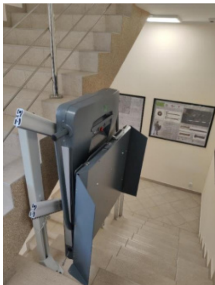
Platforma schodowa ukośna wewnątrz budynku.
