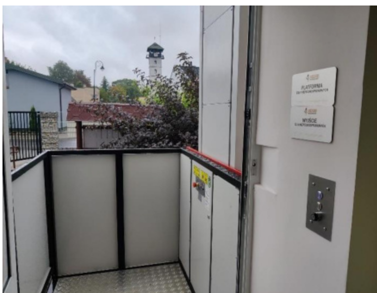
Platforma schodowa pionowa na zewnątrz budynku z zadaszeniem.
